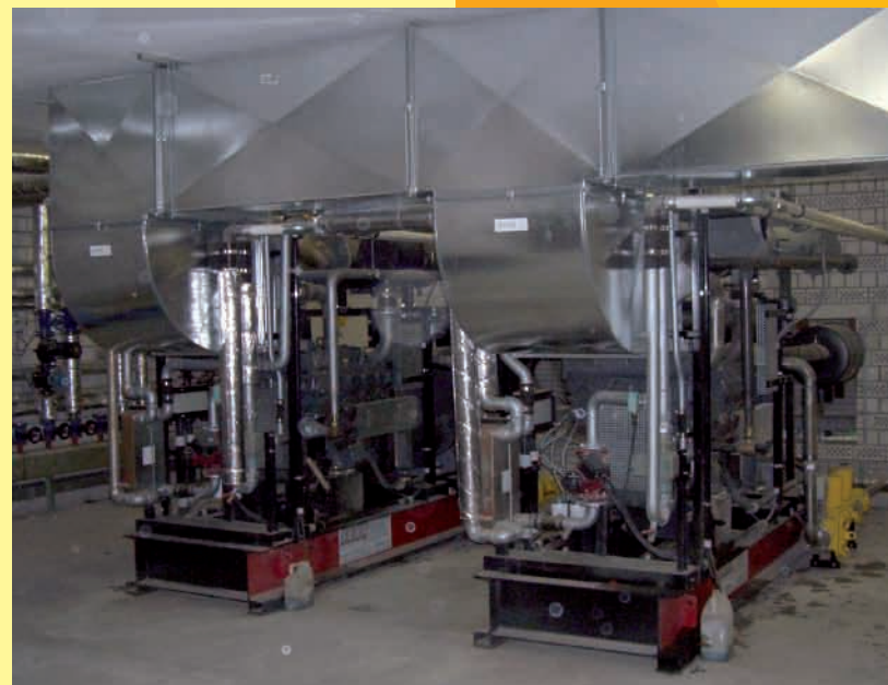
Motorenraum in der Biogasanlage Rethem
